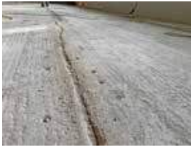
Fissures dans la plaque de fond
