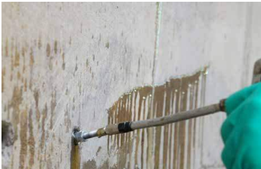
Injection dans une fissure aquifère d'une cuve blanche pour atteindre la classe d'étanchéité 1.
