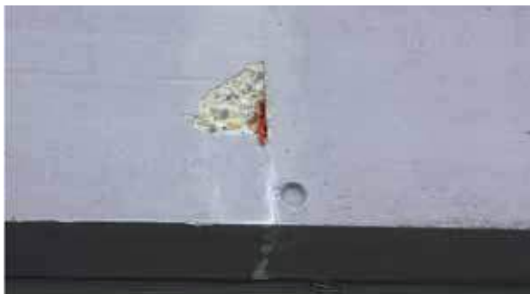
Éclatement en raison d'un recouvrement insuffisant
